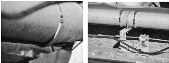
写真9 硫酸送酸管の接続部および下部
