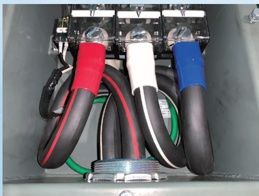
狭所配線事例
