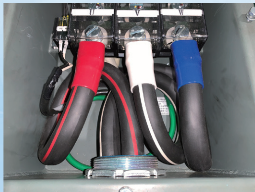
狭所配線事例
