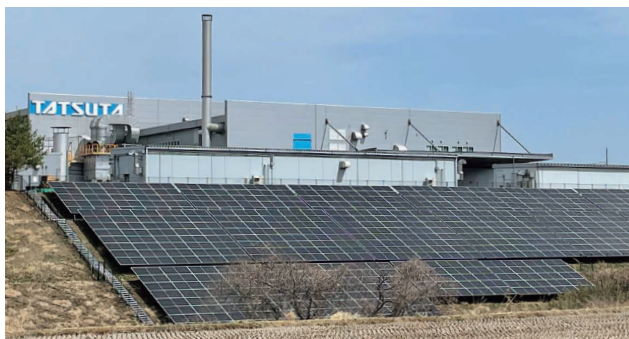
仙台工場の太陽光発電設備
