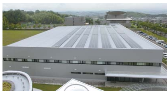
◇写真は、TTCの工場棟に設置した太陽光発電パネルです。
