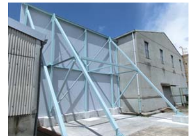
◇写真は、騒音低減対策の一環として設置した防音壁です。
