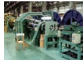
導入した電線製造設備
