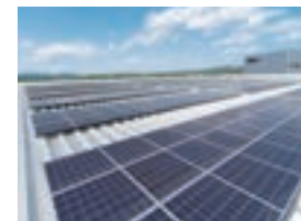
タツタテクニカルセンター工場棟に設置の太陽光発電モジュール
