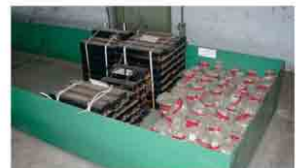
◇写真は、安定器とネオントランスの保管状況です。
